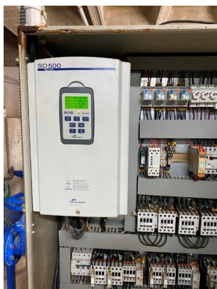
Figura 81. Cuadro con variador de frecuencia
