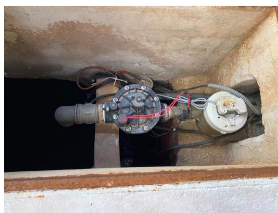
Figura 89. Contador y electroválvula
