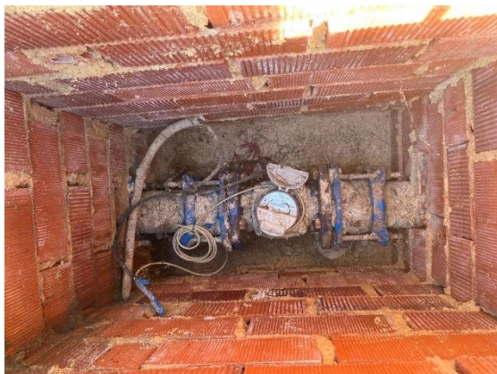
Figura 48. Contador en tubería de entrada
