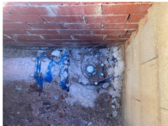
Figura 49. Contador en tubería de salida
