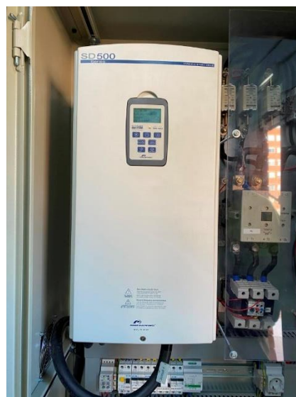
Figura 87. Cuadro con variador de frecuencia
