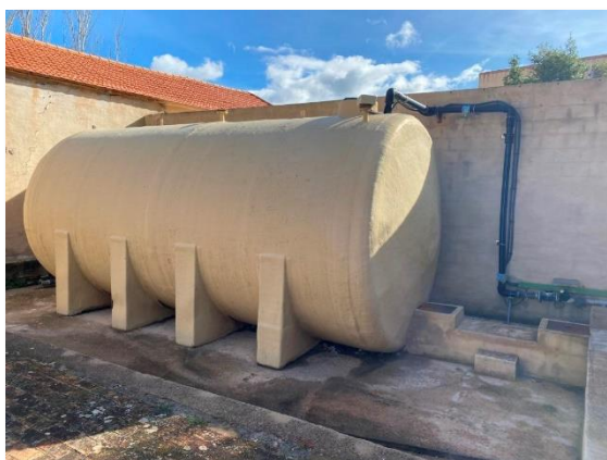
Figura 92. Depósito de aspiración de PRFV
