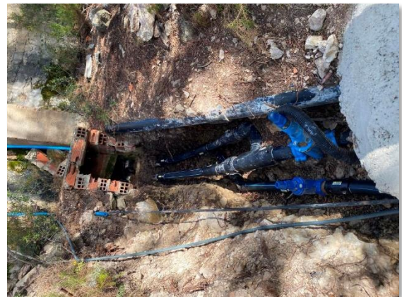
Figura 58. Tubería de salida y desagüe
