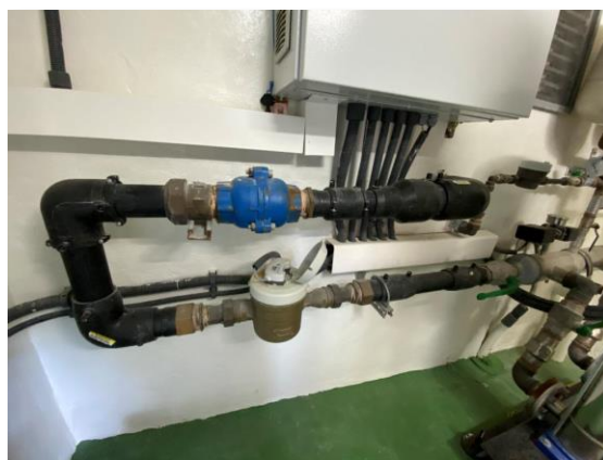
Figura 103. Tubería de salida con contador
