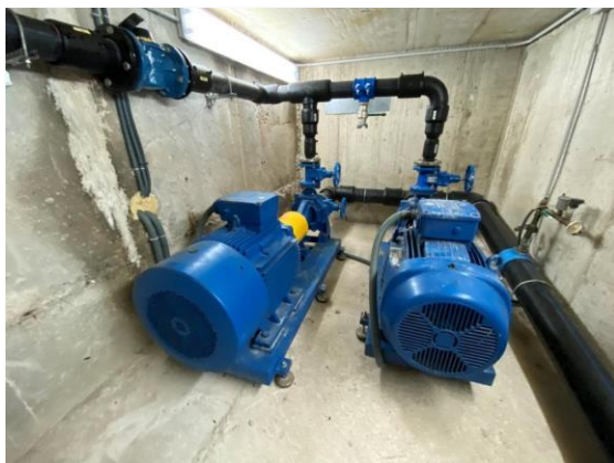
Figura 83. Bombas de la EBAP Nodriz
