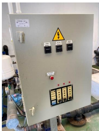
Figura 90. Variador de frecuencia
