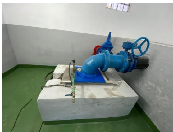
Figura 14. Tubería impulsión y arqueta rotura
