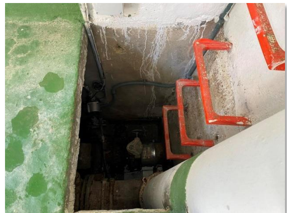
Figura 40. Tubería de salida del depósito
