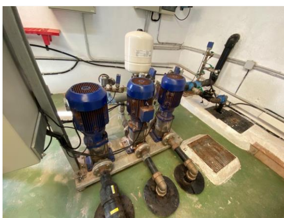
Figura 88. Bombas de la EBAP Olivar Bassa
