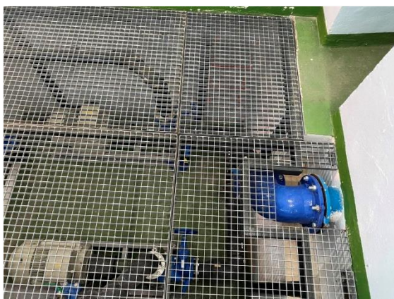
Figura 86. Bombas de la EBAP Arsenal
