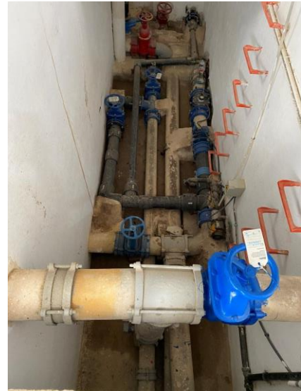
Figura 64. Tuberías de entrada y salida
