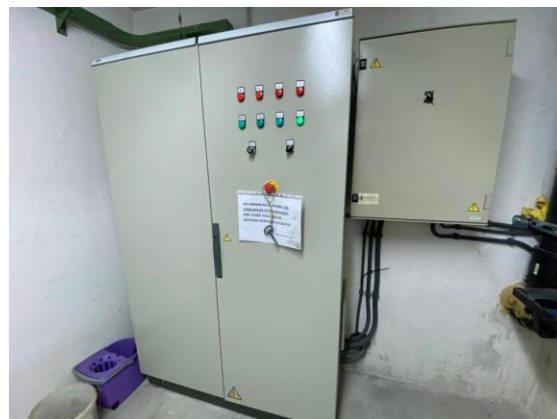
Figura 84. Cuadro de maniobra y telecontrol
