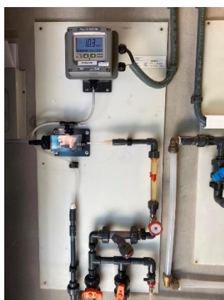
Figura 46. Analizador en continuo de cloro (entrada)
