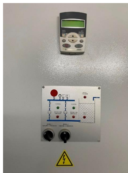
Figura 101. Cuadro de maniobra con variador de frecuencia
