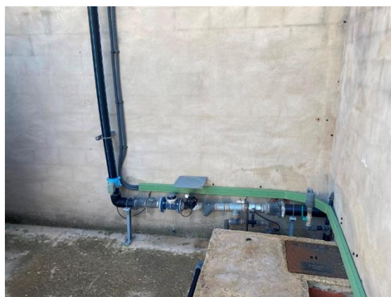
Figura 93. Tubería de entrada con contador y electroválvula
