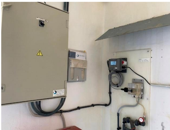
Figura 39. Analizador en continuo y telecontrol
