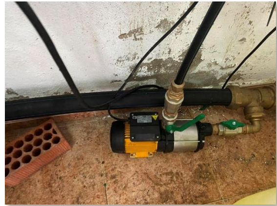
Figura 72. Bomba de recirculación
