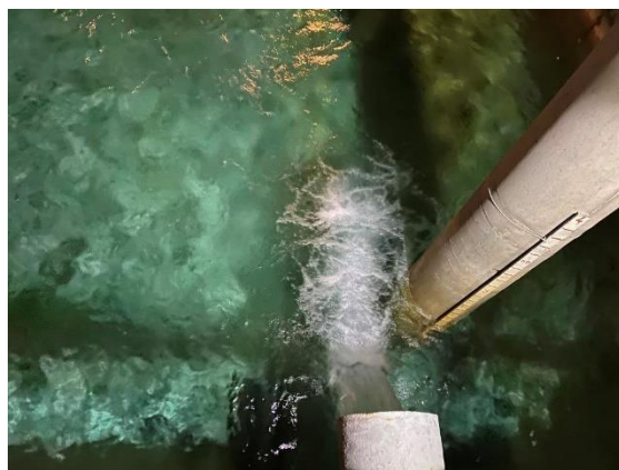
Figura 33. Tubería de entrada de agua al depósito
