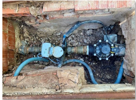
Figura 56. Contador en tubería de entrada y electroválvula
