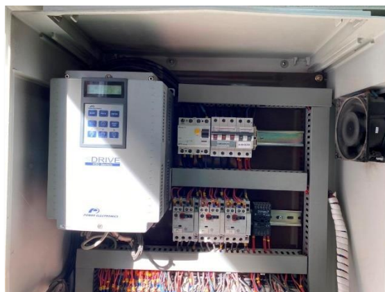
Figura 97. Cuadro con variador de frecuencia
