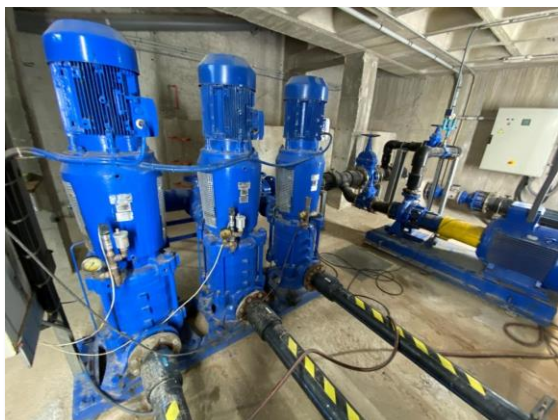
Figura 79. Bombas verticales de la EBAP Camí
