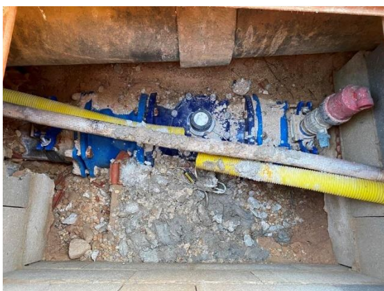
Figura 69. Contador en tubería de salida
