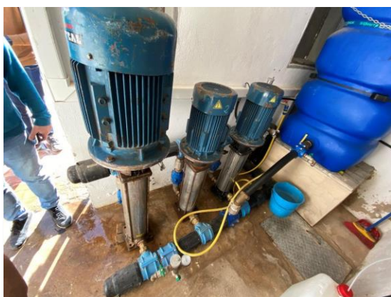
Figura 94. Bombas de la EBAP Preventorio
