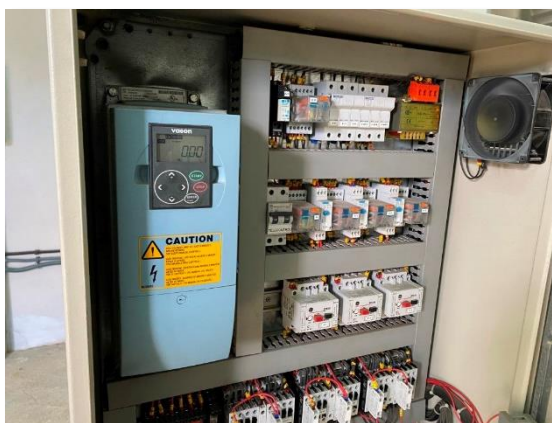
Figura 106. Cuadro de maniobra y variador de frecuencia
