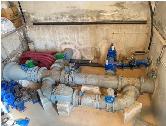
Figura 44. Tuberías de salida
