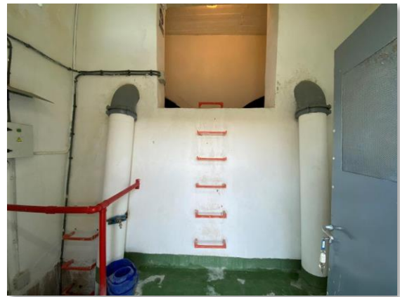
Figura 38. Tuberías de entrada al depósito
