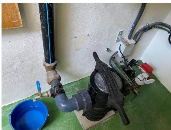
Figura 102. Tubería de entrada con filtro y contador
