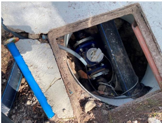
Figura 57. Contador en tubería de salida
