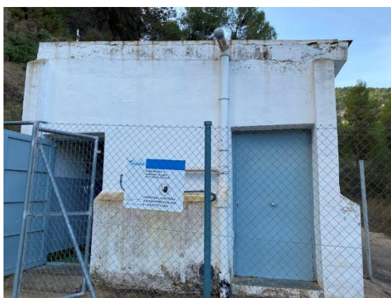
Figura 13. Vista exterior pozo Molinar 1
