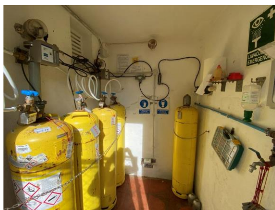
Figura 27. Dosificación de cloro gas
