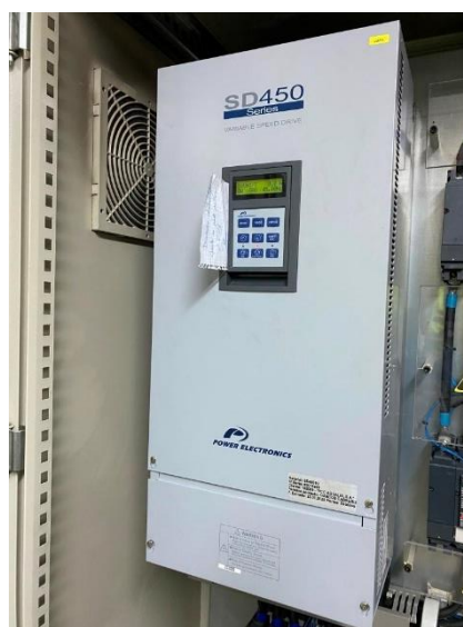
Figura 85. Variador de frecuencia
