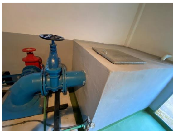
Figura 17. Tubería impulsión y arqueta rotura
