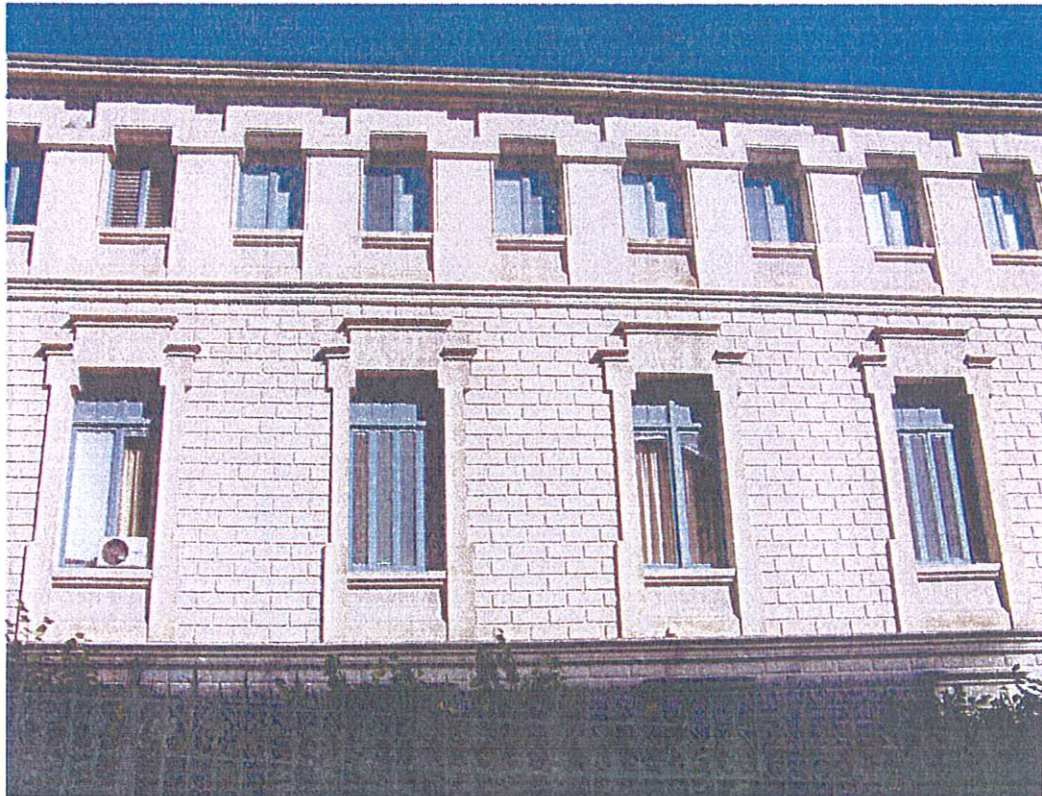
Fotografía nº 6. Vista particular de parte de la fachada a la calle B. J. Gallardo, en que se observa la fenestración de la planta primera y segunda, con distintos tipos de particiones de la carpintería y algunos elementos impropios.
